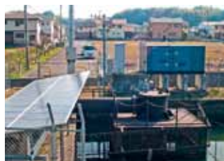
雨水設備のトータル管理
