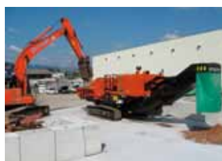
バイオマス燃料破砕施設
